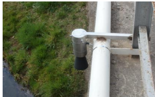
Foto - Ultrazvukový hladinoměr na mostovce
